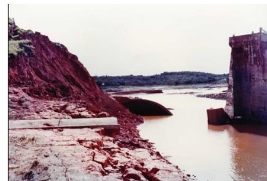
Figura 29: Vista da ombreira esquerda da barragem após sua ruptura Fonte: SSRH (1985) apud Menezes (2016)
