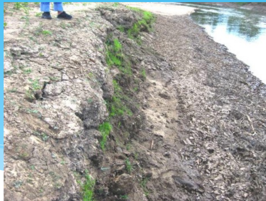
Figura 08. Encosta da margem direita do Rio Providência cedendo.
