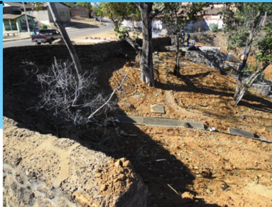
Fig.19 - Vista da área do buracão desmoronada.
