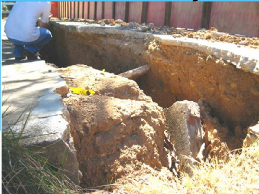
Figura 03. Vista parcial da ruptura da estrutura.
