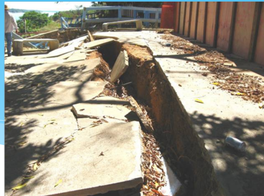
Figura 4. Vista parcial das estruturas comprometidas.
