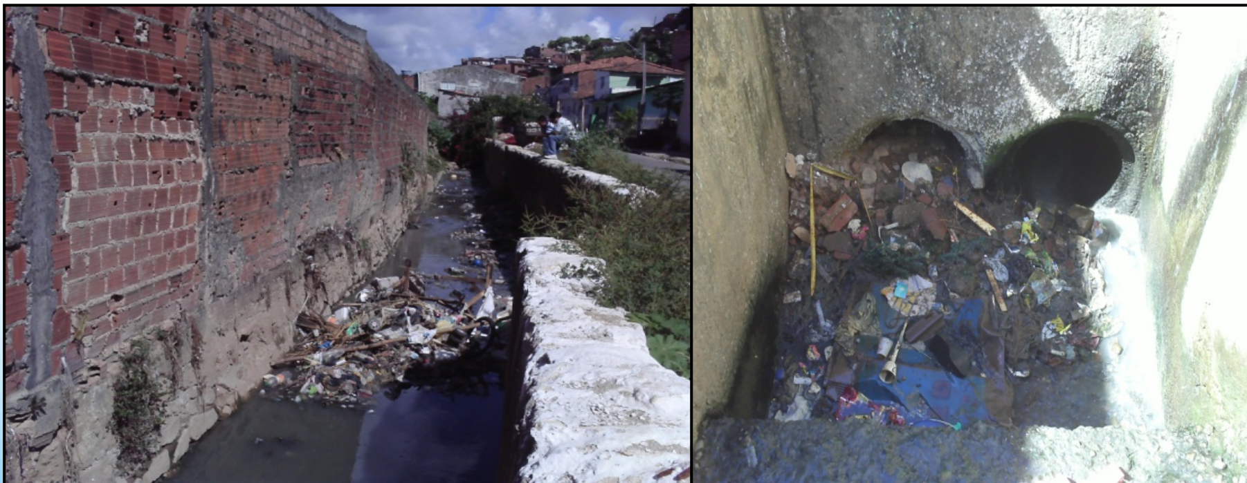
Figura 4 e 5 – Trecho próximo ao exutório da bacia e Pontos de disposição inadequada e acúmulo de resíduos nos componentes de drenagem urbana (Fonte: Arquivo pessoal).
