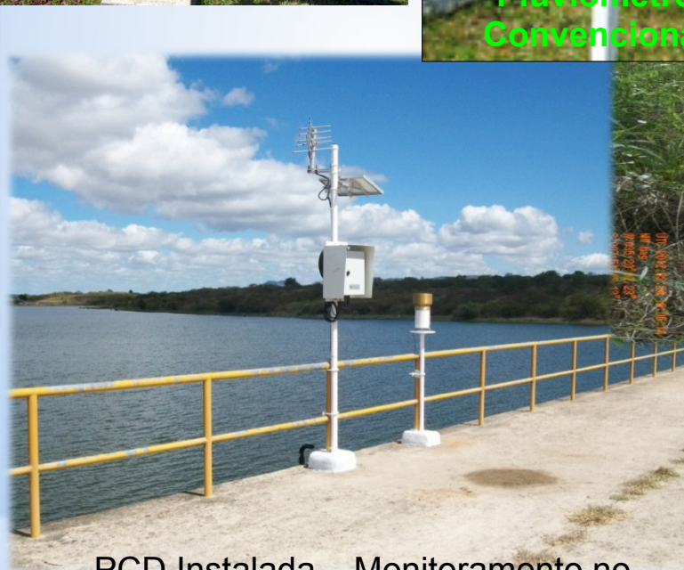
PCD Instalada – Monitoramento no Reservatório Belo Jardim
