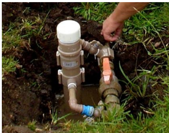
Figura 2 – Clorador instalado e em funcionamento diretamente à canalização através de colar de tomada
